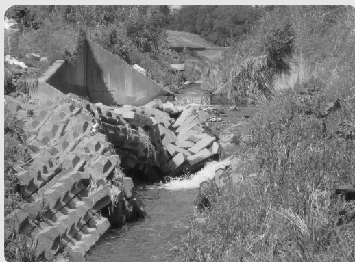
紅葉川護岸破損
